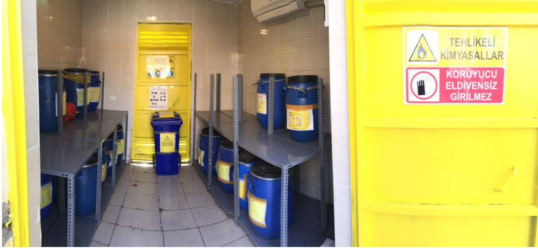
Şekil 2. Tehlikeli Kimyasal Atık Geçi Depolama Alanı
